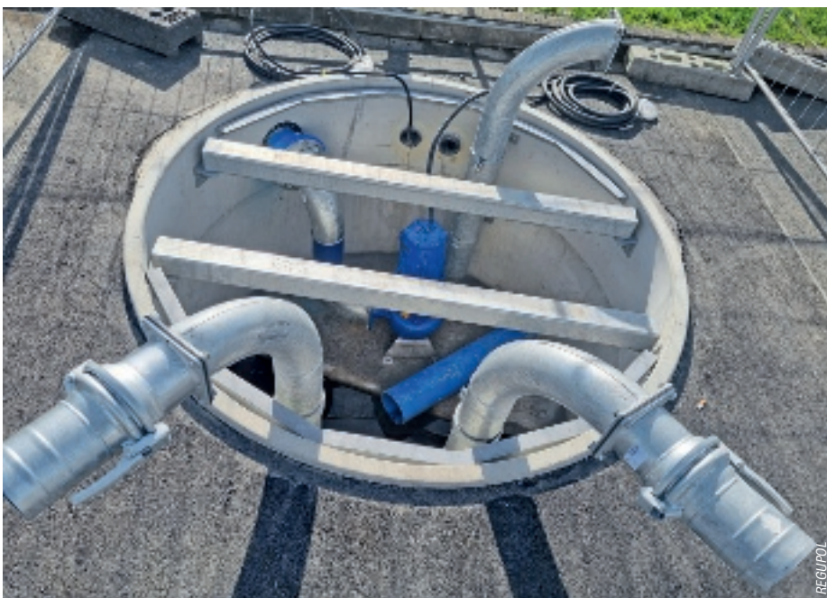
Zum Aktionsplan der Firma REGUPOL gehört unter anderem ein Pumpensumpf, der bei Starkregen zum Einsatz kommt und große Schäden verhindert.
